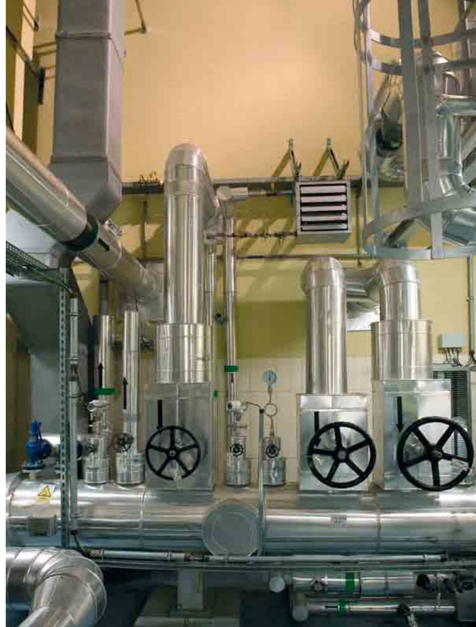
▲ Główny rozdzielacz pary technologicznej – Stacja Termicznej Utylizacji Osadów
