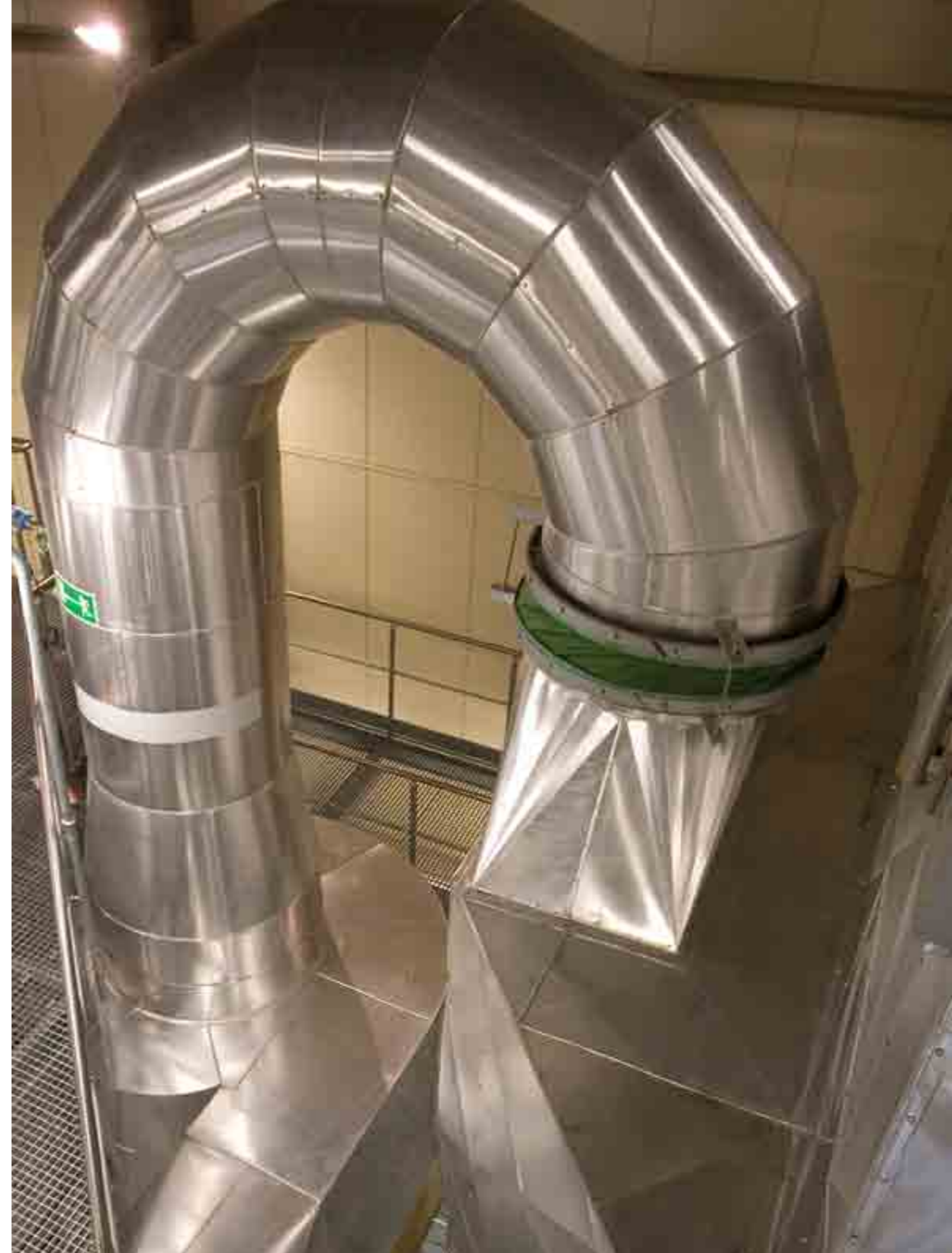
▲ Kanał spalin łączący multicyklon z elektrofiltrem – Stacja Termicznej Utylizacji Osadów
